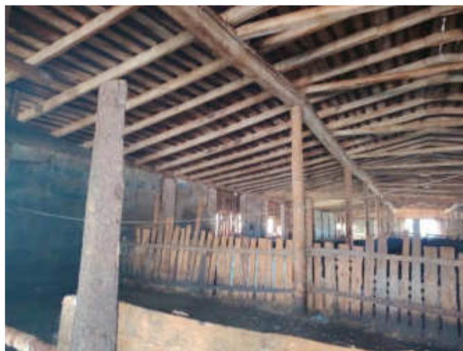
Гниль и прогибание опорных балок
