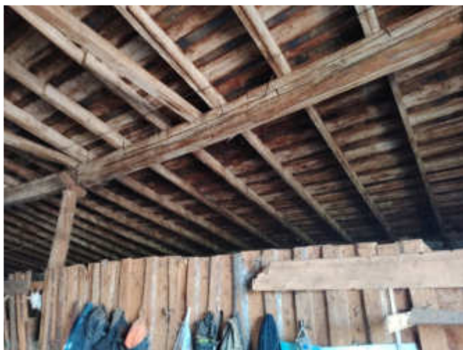
Гниль и прогибание опорных балок
